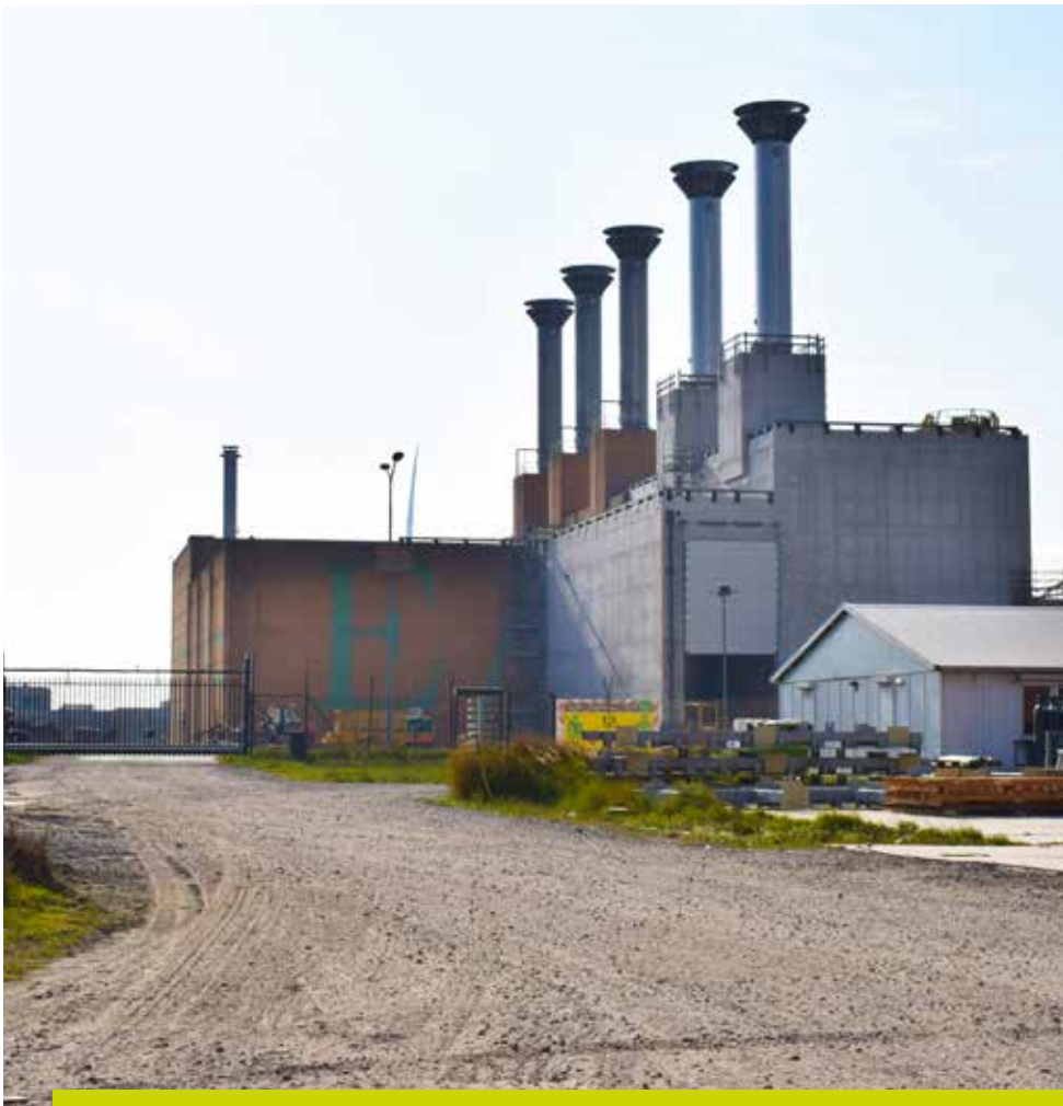
X De contouren van de uitbreiding zijn compleet, inclusief de nieuwe RVS-schoorstenen.
