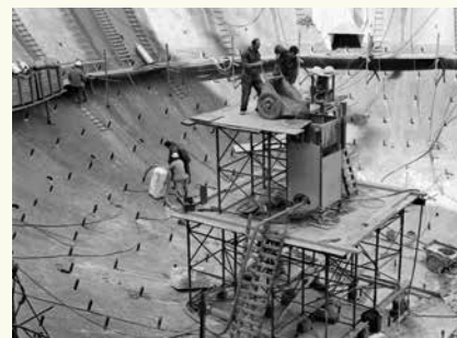
➤ Bouw van de kerncentrale in het Sloegebied bij Borssele. Werkzaamheden door de firma Societ - Bronvermelding: Zeeuws Archief, Foto Dert, nr 1641
